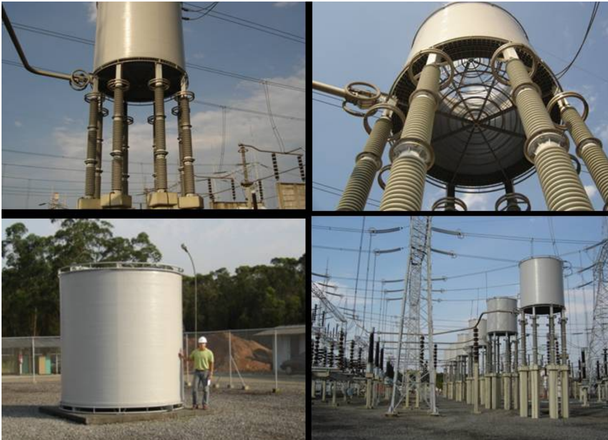
Figura 14 RLCs existentes na subestação de Mogi das Cruzes
