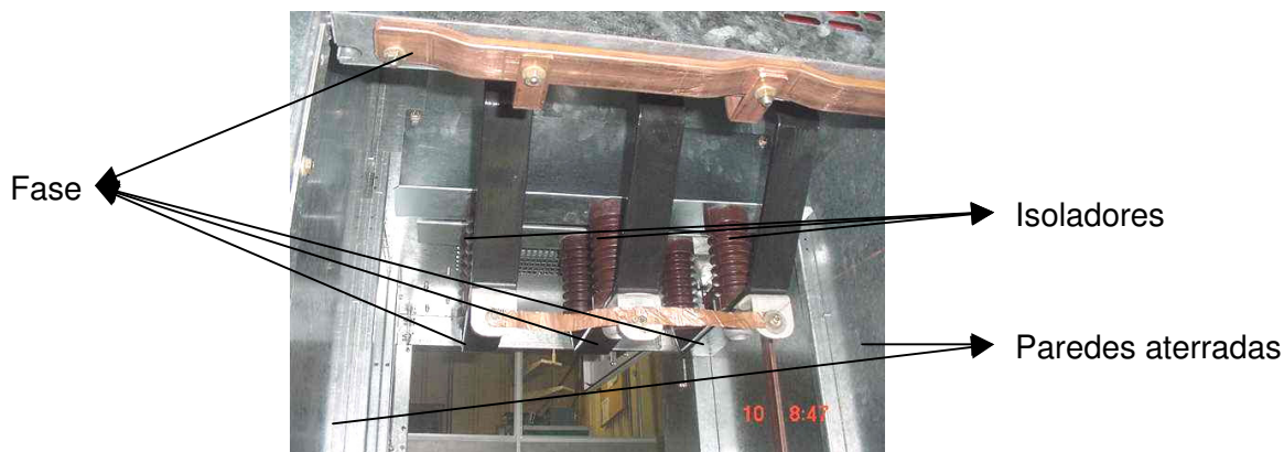
Figura 5.4 – Foto de um cubículo, isoladores e barras
