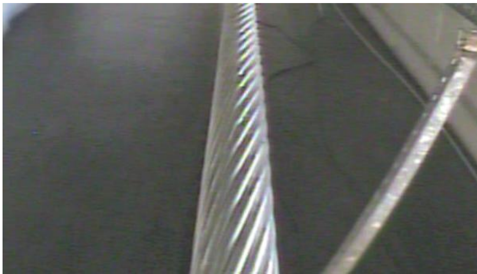
FIGURA 5.23: Cabo condutor visto pela câmera de vídeo do robô
