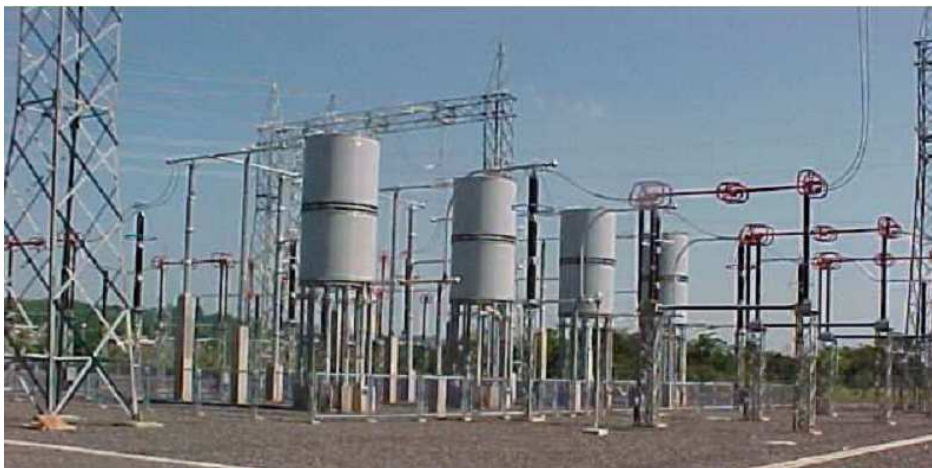
Figura 3.1: Fotografia dos Reatores limitadores na subestação de Tucuruí - PA.
