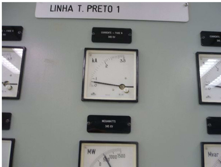
Figura 9 - Amperímetro a ser substituído pelo sistema de medição de correntes harmônicas
