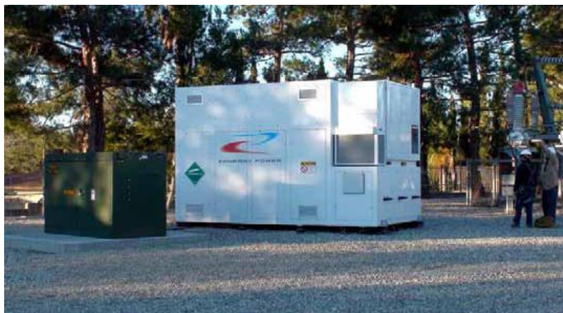
Figura 36 – Protótipo de SFCL da Zenergy Power em operação [2].
