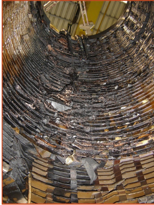
Figura 2.9 - Danos no enrolamento de 13,8kV de um autotransformador de 230/161-13,8 kV
