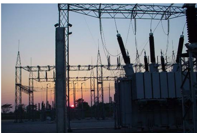
Figura 2.2 – Detalhe de um autotransformador na subestação de 765/500/345 kV Tijuco Preto – Furnas
