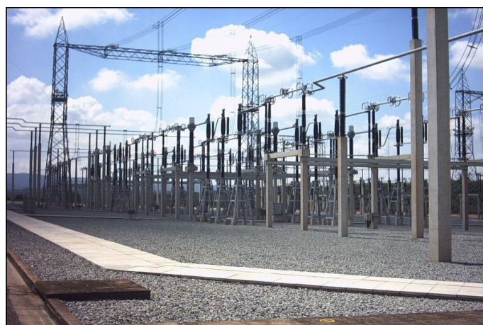
Figura 2.3 – Subestação de 500/345 kV Ibiúna – Furnas
