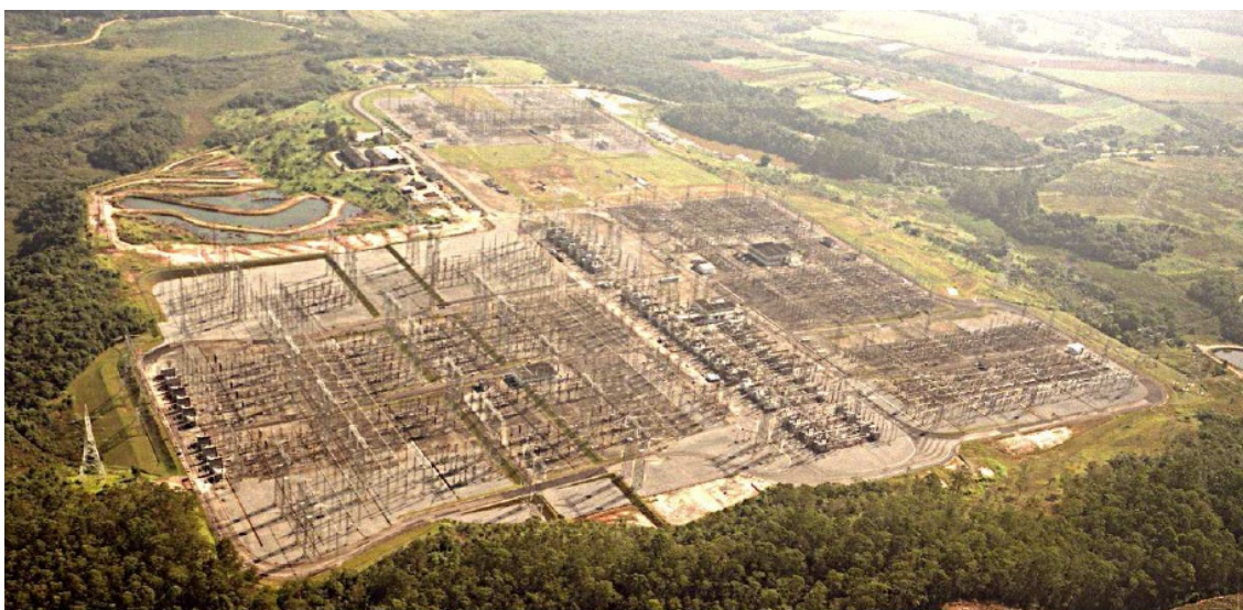
Figura 2.1 – Visão aérea da subestação de 765/500/345 kV Tijuco Preto – Furnas
