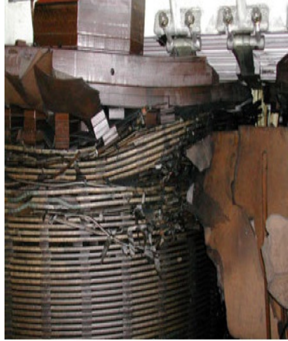
Figura 2.8 – Danos na região superior da bobina de alta tensão da fase central
