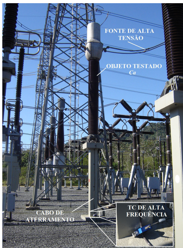
Figura A.8: Medição de DP em TC utilizando um transformador de corrente de alta frequência.
