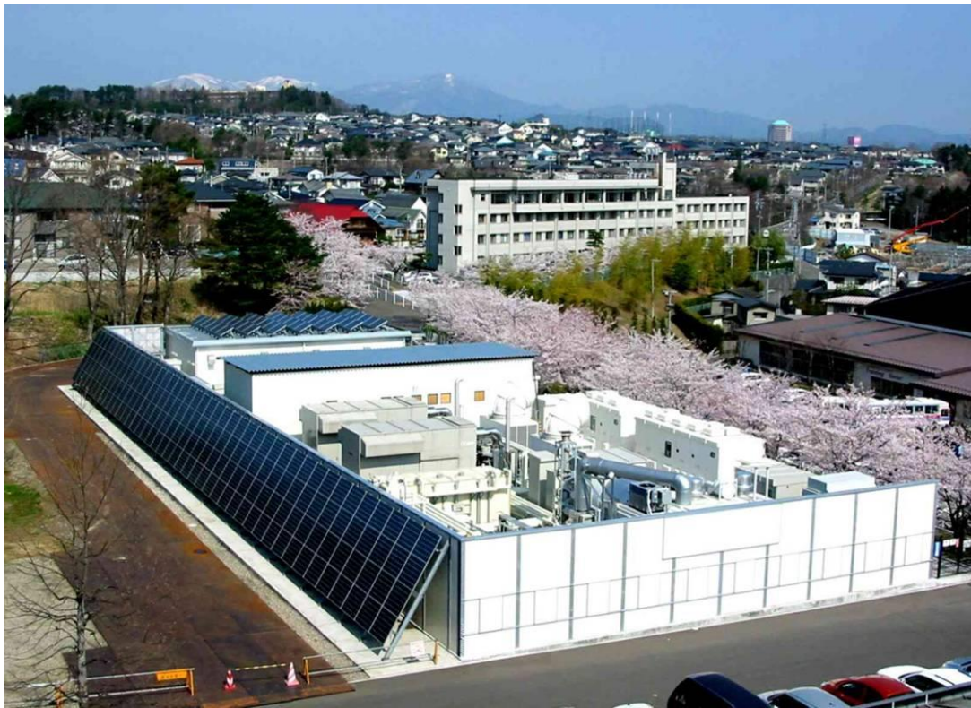
Figura 5: Foto do Centro de Energia do projeto Sendai.
