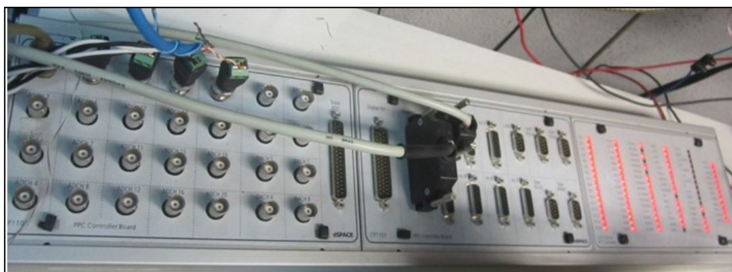
Figura 5.2. Painel de conexão CLP1103.
