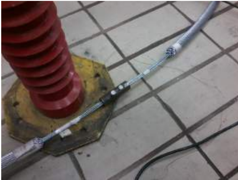
Figura 3.16. Detalhe do fechamento do circuito magnético formado pelo núcleo de aço do cabo.
