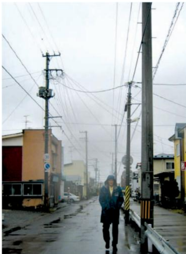
Figura 3.2 – Rua com redes de distribuição pública e privada - MR Hachinohe [56]
