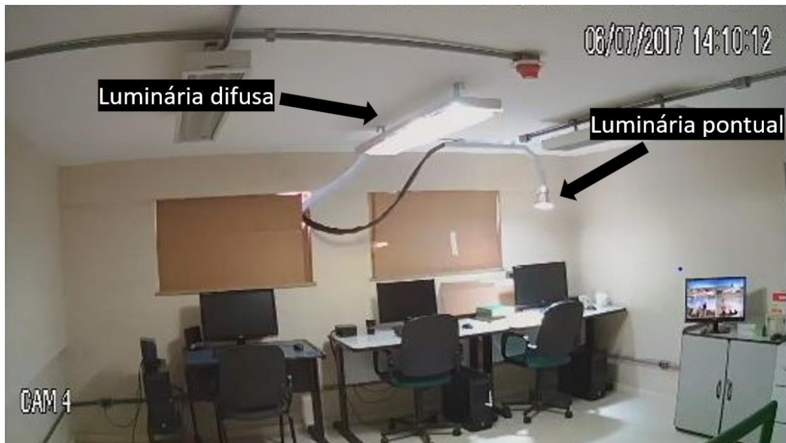
Figura 40 - Sala iluminada pelas luminárias pontual e difusa
