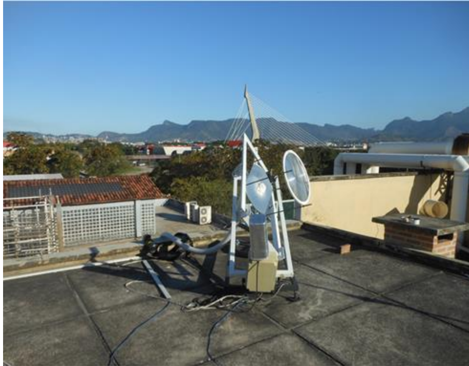
Figura 3 - Rastreador instalado em um terraço na cidade universitária
