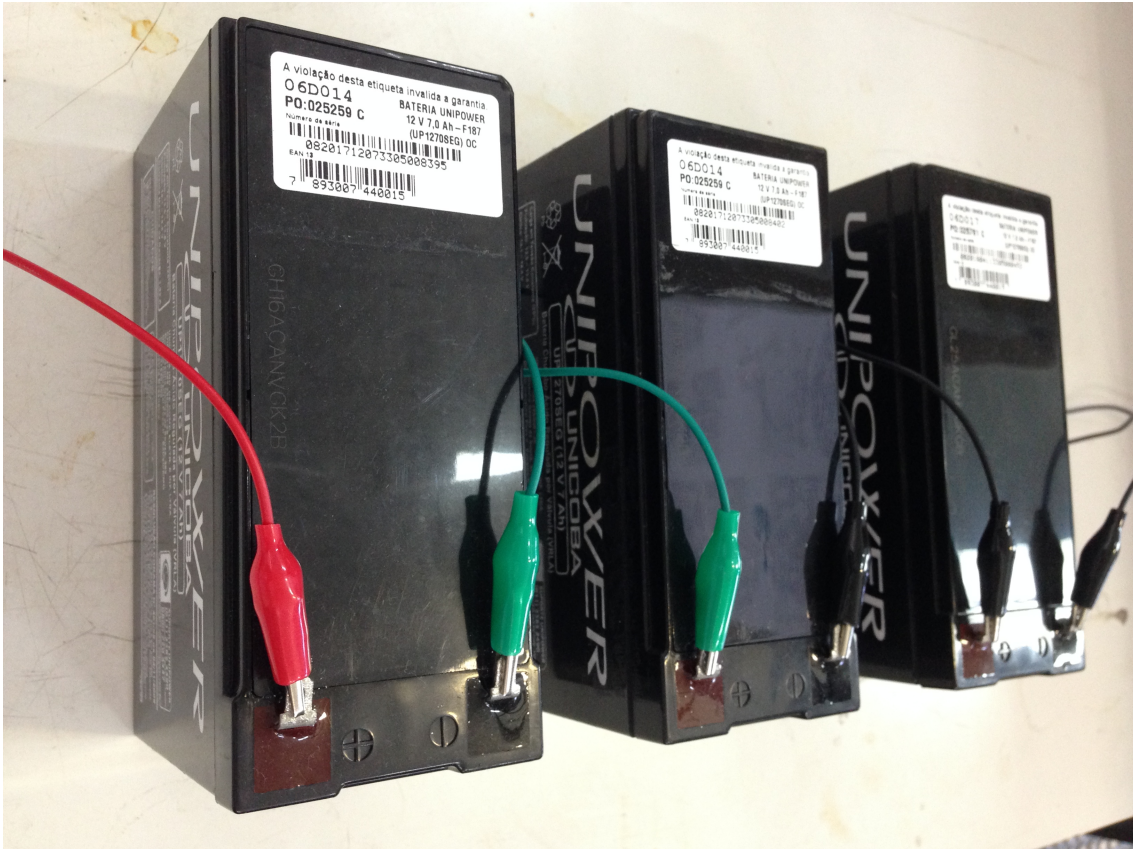
Figura 4.31: Banco de baterias utilizado para alimentação do CFR.
