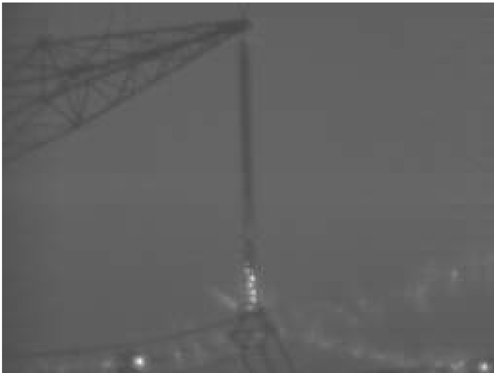
Figura 2.2: Efeito corona nas linhas de transmissão e eletrodo energizado da cadeia de isoladores.
