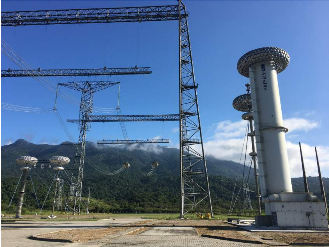
Figura 3.18: Foto do circuito de ensaio montado.
