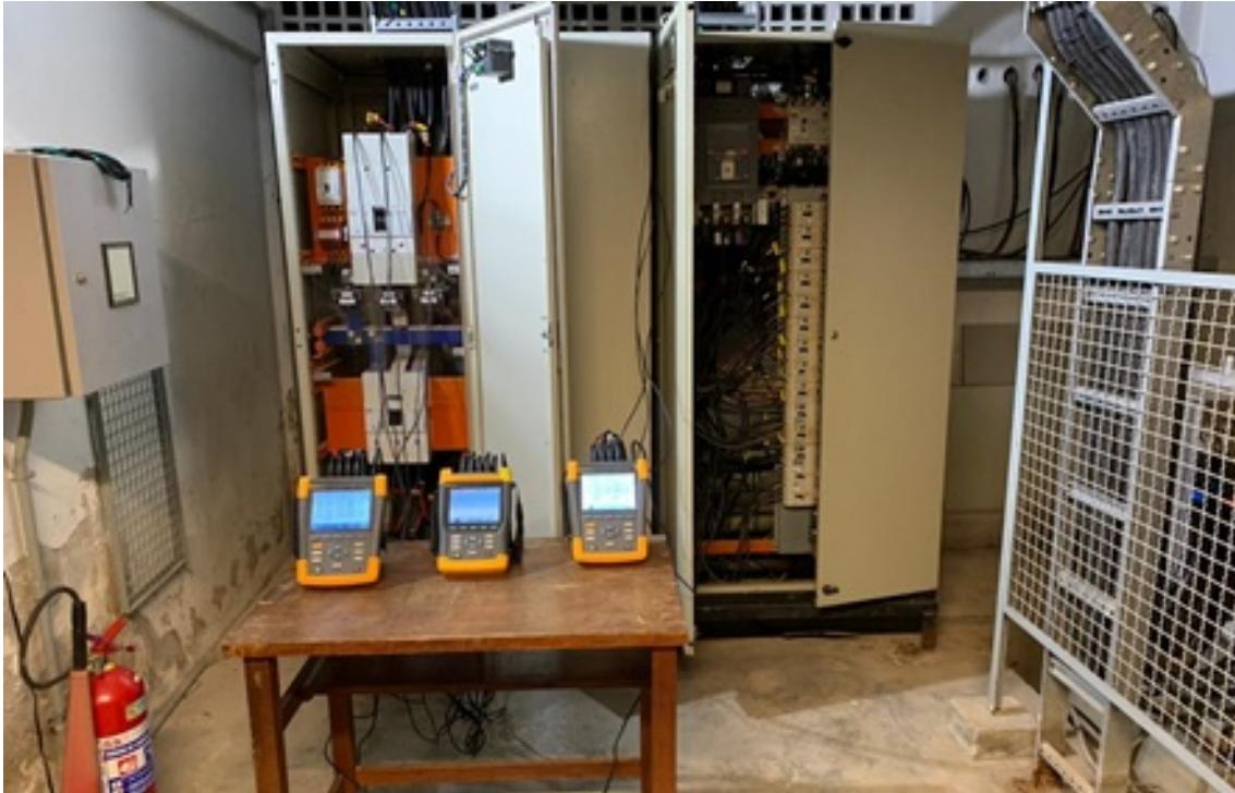
Figura 4.1: Local de instalação dos medidores - Subestação G1.
