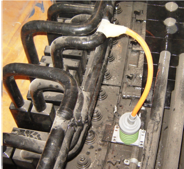
Figura 2.10: Instalação de um capacitor de acoplamento em um gerador síncrono.
