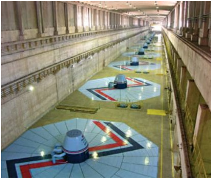
Figura 1.2: Unidades hidrogeradoras da UHE Tucuruí. (Fonte: http://www.eletronorte.gov.br )
