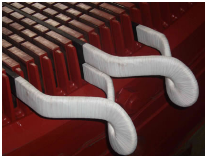
Figura 2.4: Barras encaixadas nas ranhuras do estator. A fita branca constitui um revestimento semicondutor destinado ao controle do potencial elétrico na superfície do isolamento da barra nas regiões em que esta sai da ranhura. (Fonte: http://www.gef.com.my/rewind_high_voltage_motor.html )
