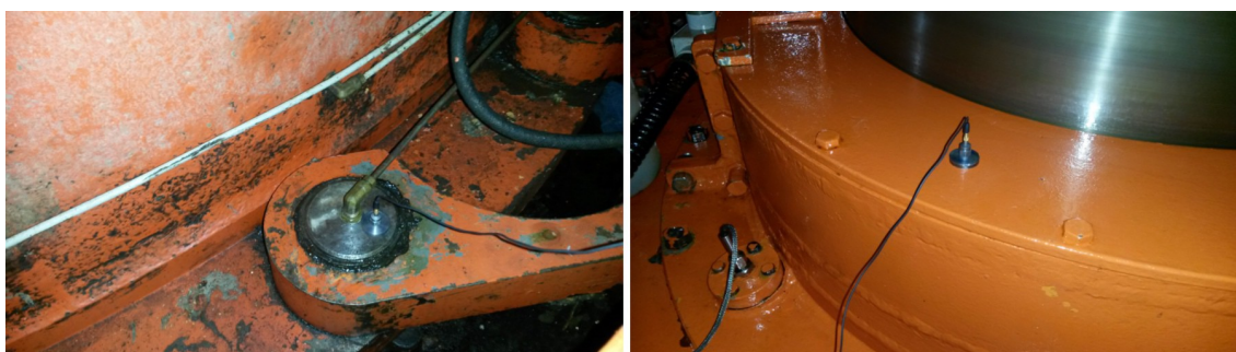
Figura 38 - Instalação dos sensores para a aquisição do conjunto de sinais número 1. À esquerda: o acelerômetro e sua base de montagem sobre o munhão. À direita: sobre a tampa da turbina.
