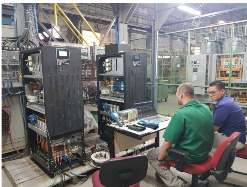
Figura A.3: Conversores durante a inspeção na fábrica da Adelco.
