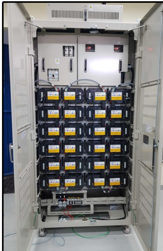
Figura A.2: Banco de baterias.
