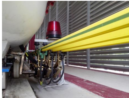
Figura 6.1 – Trilho adicional de aterramento com identificação na cor verde.
