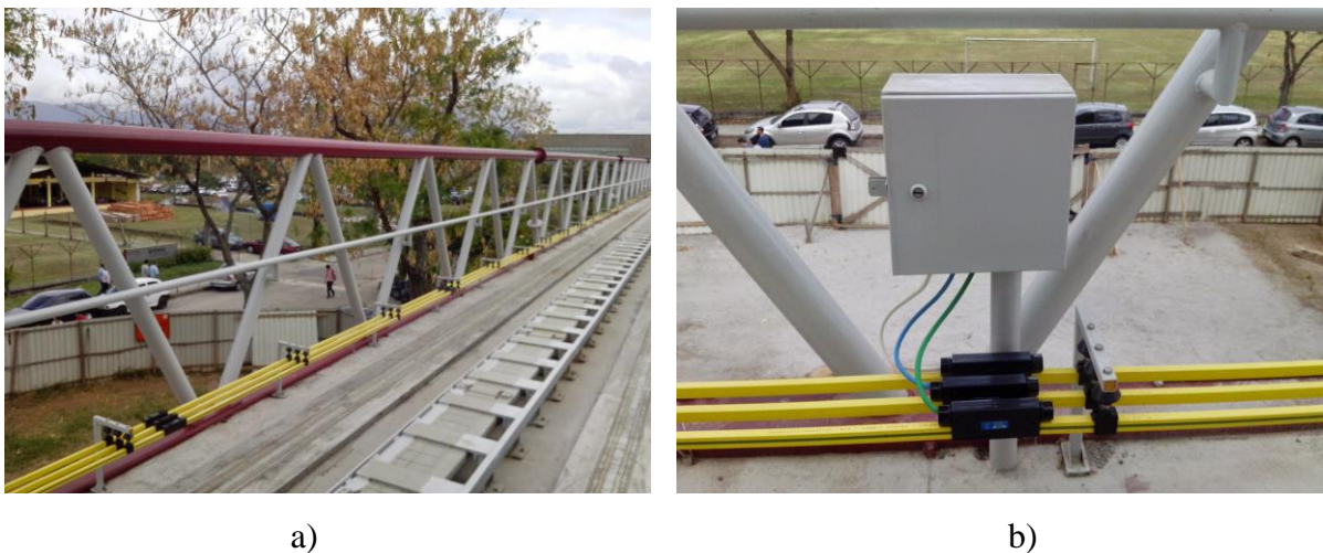
Figura 6.5 – Barramentos de alimentação do MagLev-Cobra. a) distribuição das bases de sustentação dos barramentos; b) ponto de conexão entre os cabos de alimentação e os barramentos.
